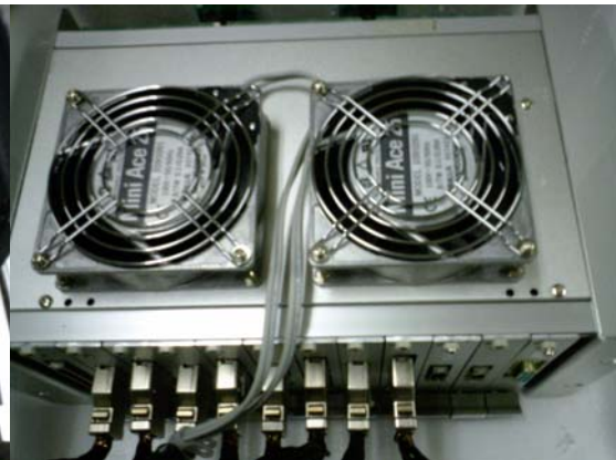
右：検出器コントローラ(ファンがついている)
